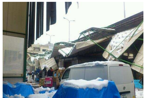
↑ 崩落した八王子にあるアーケード
